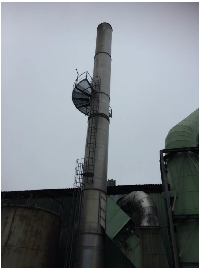
PLATEFORME DE MESURE SUR LA CHEMINEE DU NOUVEAU SECHEUR
